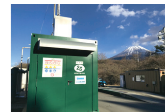
メタンガス発電機
