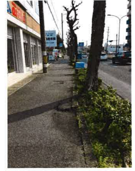
根上がりにより歩道が盛り上がっている事例
